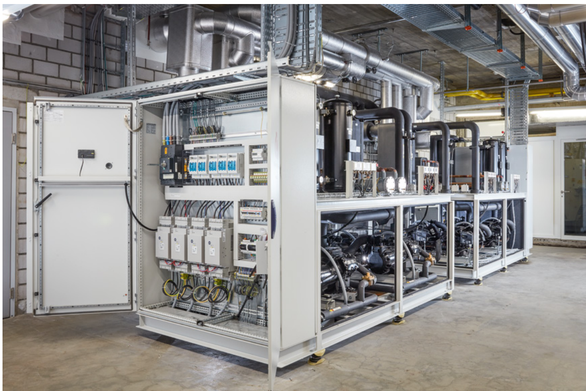
Bild: Sole-Luftkühler und Innenaufgestellte Wärmepumpen (geöffnet) eines CTAexklusiv Luft/Wasser Wärmepumpen-Systems mit 530 kW Heizleistung (Wärmeverbund St. Jakob, Basel).
